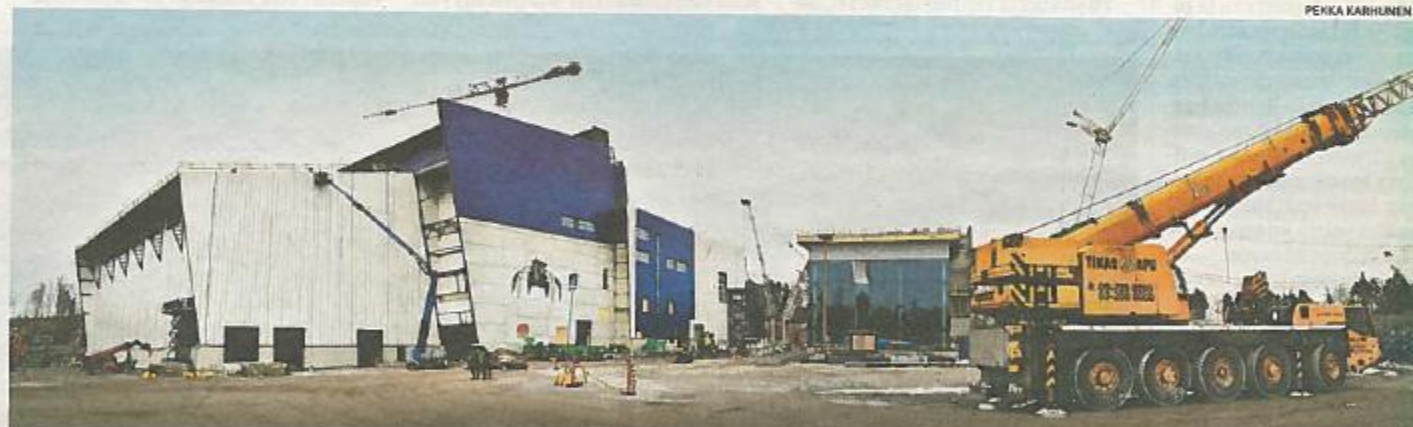
VALMISTUU VAUHDILLA. Suomen suurin jätevoimala Vantaalle voi valmistua jopa etuajassa ensi vuonna ja alittaa budjettinsa. Vuonna 2016 voimaan tuleva uusi jätelaki on vauhdittanut jätevoimaloiden rakentamista, koska orgaanisten jätteiden vieminen kaatopaikoille kielletään.
