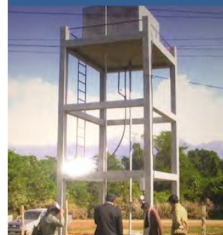
グローバル・パートナーシップ・ プログラム ラオス・ボンカン村 に建設された水供給設備
