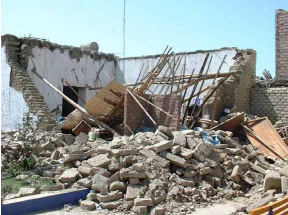
Foto 1: Vivienda de adobe destruida en Ica
