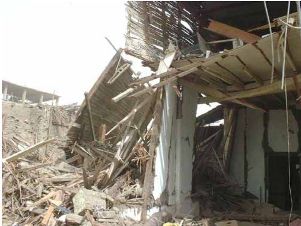
Foto 2: Destrucción de quincha en Pisco, la provincia de Ica
