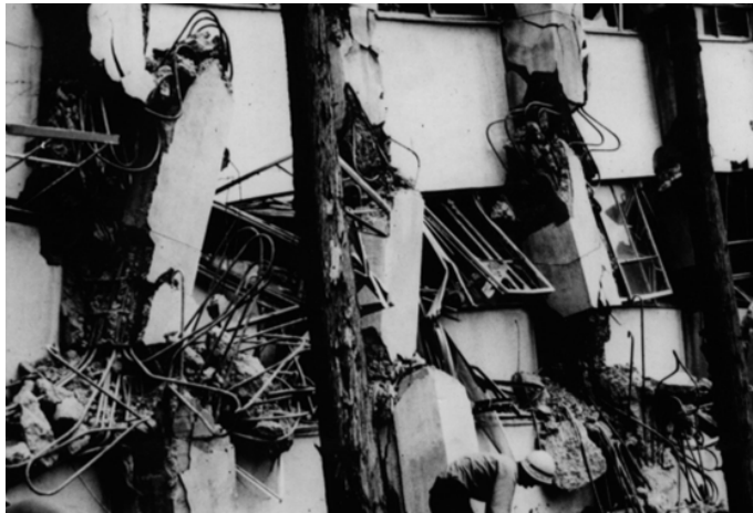
Foto 4: El edificio de la Universidad Técnica de Hakodate colapsó durante el Terremoto de Tokachi-oki en 1968
