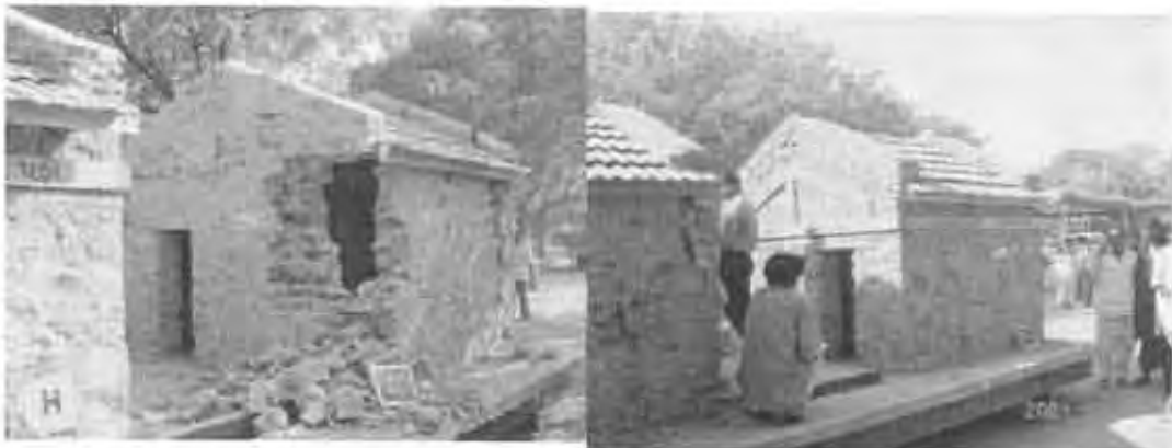
10 回目の振動による被害 (左は耐震補強なし、右は耐震補強あり) (P5-19)
