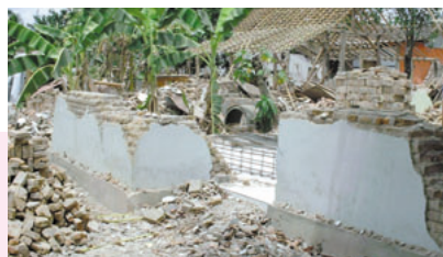
地震により倒壊した建物
